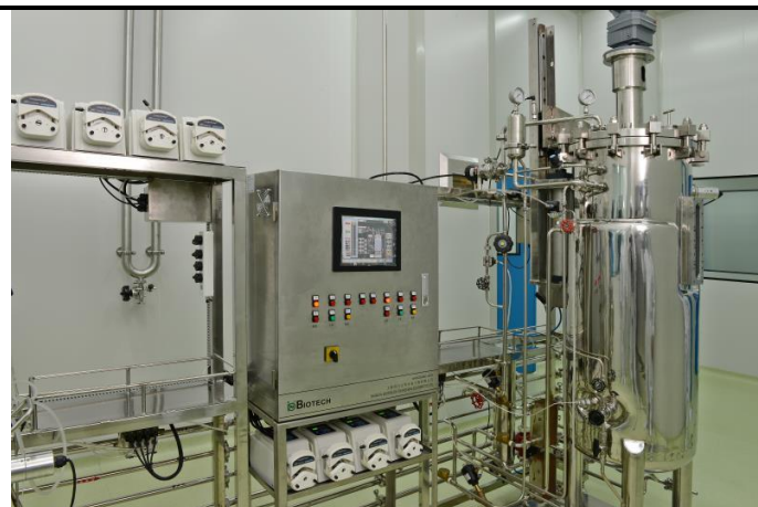
图 3: 发酵罐控制平台
